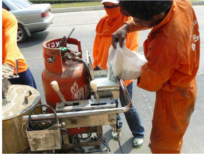
ภาพที่ 36 ภาพแสดงการเทลูกแก้วลงในเครื่องตีเส้นจราจร
